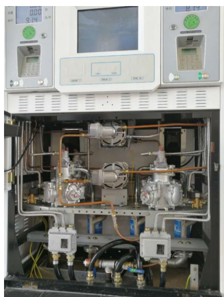
加油油气回收装置
