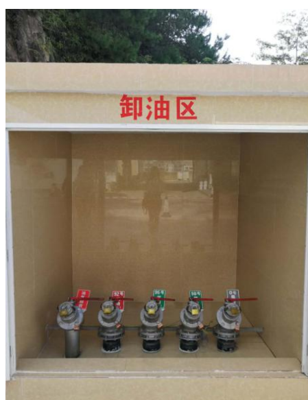
卸油油气回收装置
